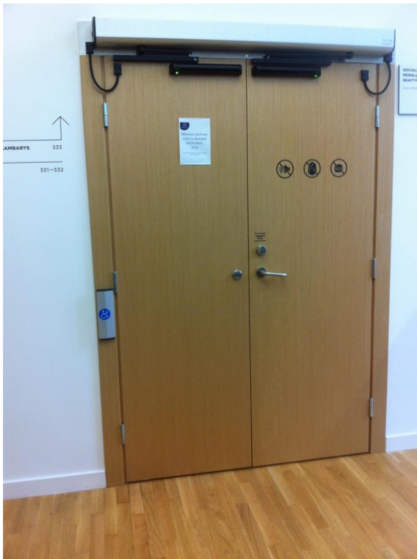
Obr. 10 - Dveře s automatizovaným otvorením
